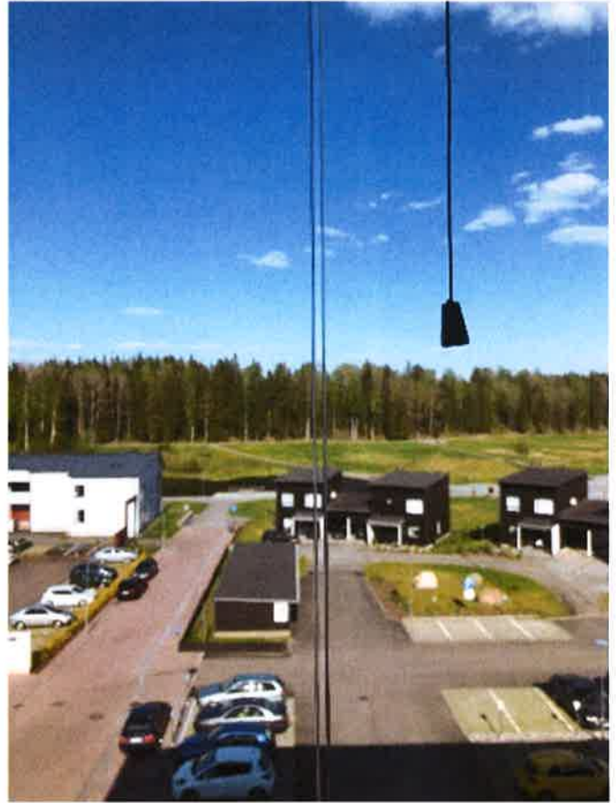
Kuva 4 Parvekelasien välissä oleva rako
